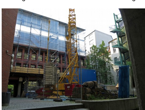
Der Innenhof ist wie das halbe Obergeschoss derzeit nicht benutzbar
