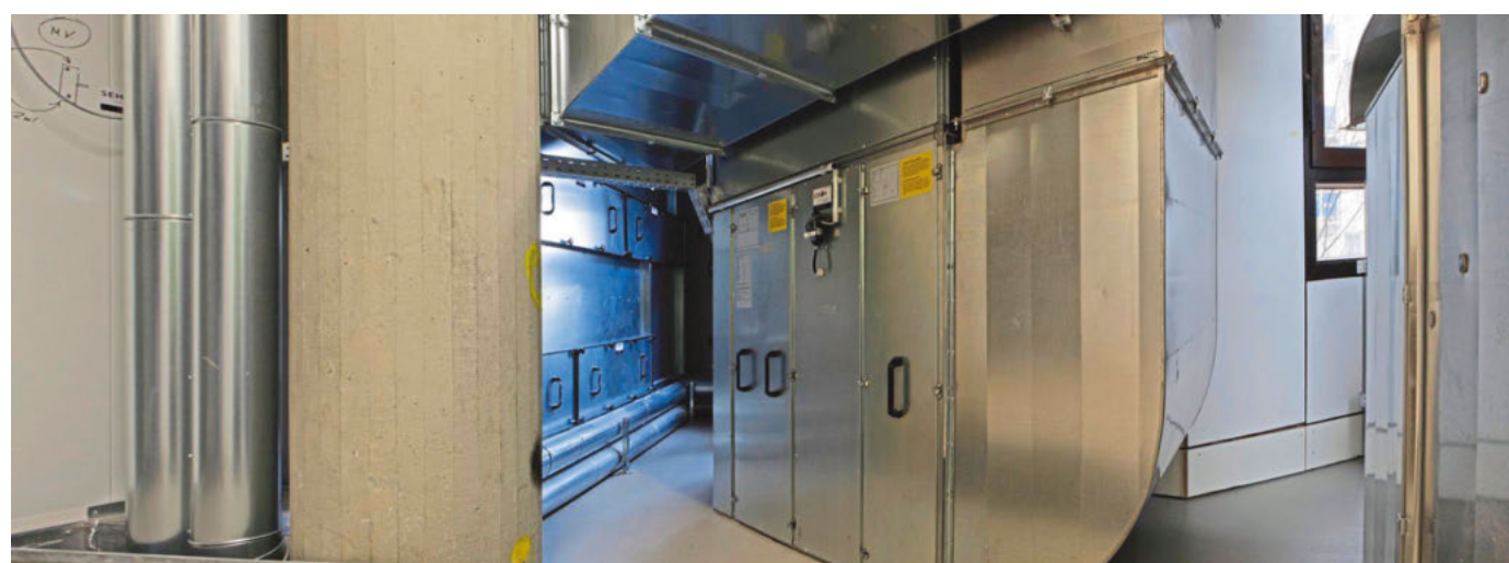
Ein Blick in die gewaltige Technikanlage hinter der Lackierkabine
